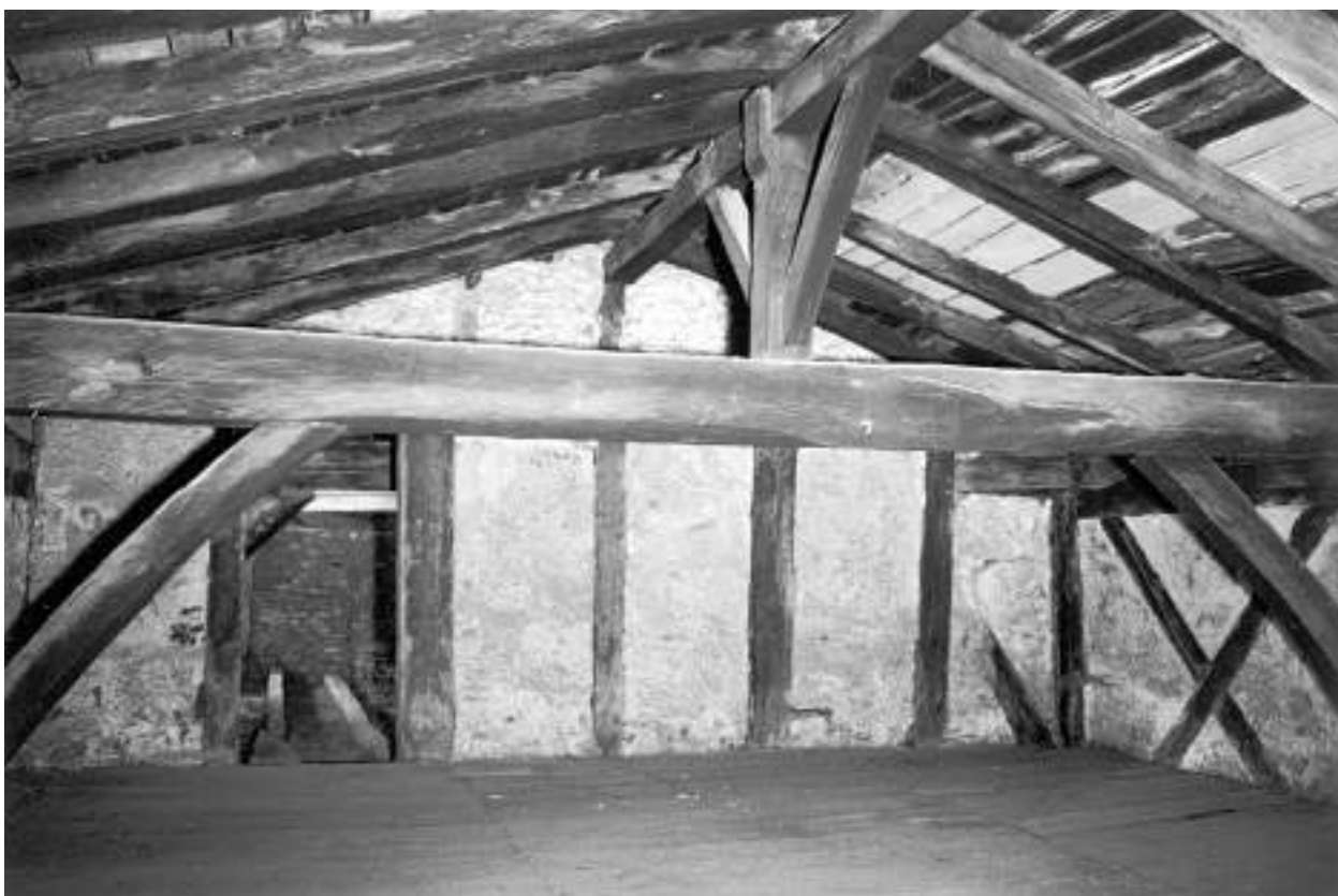
Igartza jauregia. Teillatuaren zurezko egitura. Iparraldea. / Estructura l nea del tejado. zona norte.
